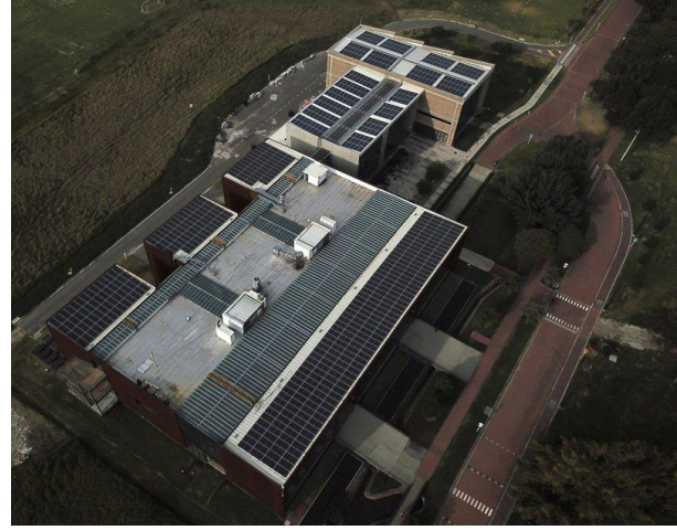
Figura 3. Sistema fotovoltaico de la Universidad Escuela Colombiana de Ingeniería Julio Garavito. Fuente: elaboración propia.
