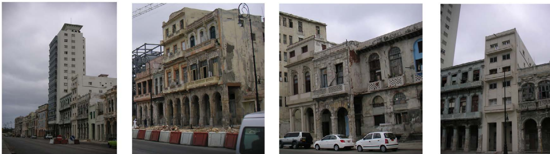
Imágenes que muestran el avanzado grado de deterioro de las edificaciones del Malecón Tradicional
