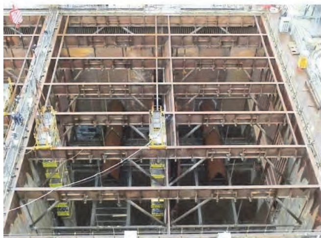
Figura 2. Arriba) Inserción de las paredes divisorias para crear los compartimentos. Abajo) Montaje de los conductos de by-pass. Fuente: Fotos propias.
