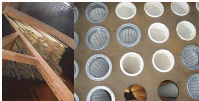
Figura 4. Instalación de las mangas. a) Vista interna del compartimento b) Detalle del sistema snap-ring y de la jaula portamangas, visto desde la parte superior “walk in plenum”. Fuente: Fotos propias.
