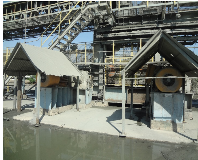
Figura 11. Sistema de accionamiento de una correa transportadora de una mina de cobre al sur del estado de Pará - Brasil.
