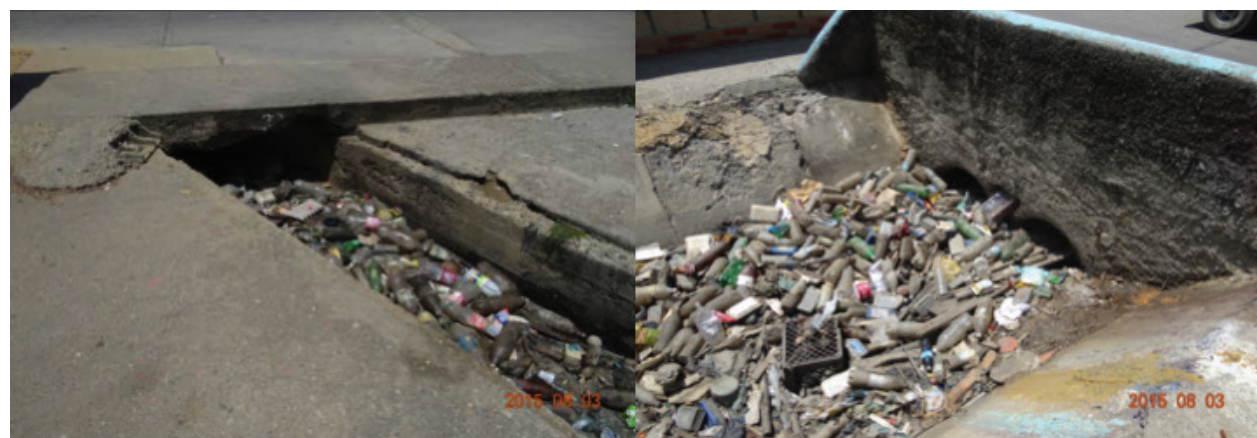
Figura 4. Desagües obstruidos por acumulación de residuos en Laurencio Silva, Venezuela
