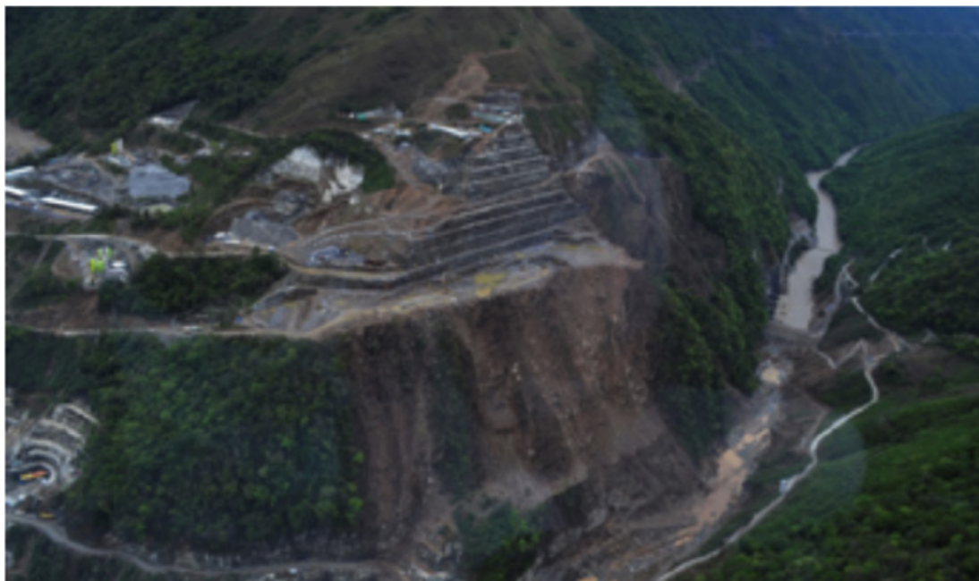
Imagen 3. Fotografía aérea del proceso de construcción de la Central Hidroeléctrica Ituango. Fuente: Svenswikipedia, (2014) / Figure 3. Airborne image of the construction process of Central Hidroeléctrica Ituango. Source: Svenswikipedia (2014)
