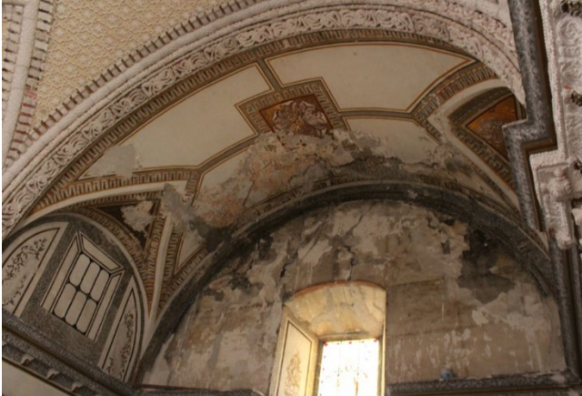
Figura 13. Patologías en la zona del coro. Fuente: Fotografía tomada por Cárdenas-López, 2023.
