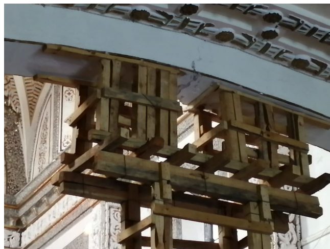
Figura 4. Detalle del daño del arco. Fuente: Fotografía tomada por Muñoz-Flores, 2019.
