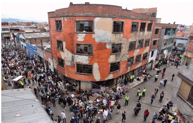
Figura 2. Edificio desgastado en el Bronx. Fuente: Primicia Diario 2016.
