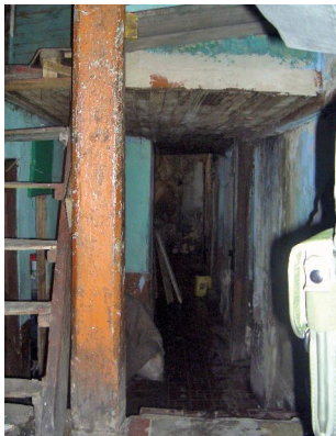
Figura 7. Interior de casas de San Bernardo derrumbadas para la construcción de la Avenida calle 6 y que fueron reocupadas como “sopladeros” por habitantes de calle
