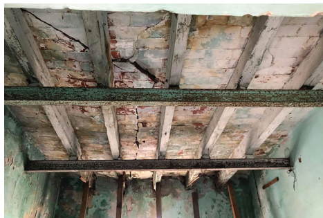
Figuras 7 y 8. Vistas desde el interior de los daños en las losas de la azotea.
