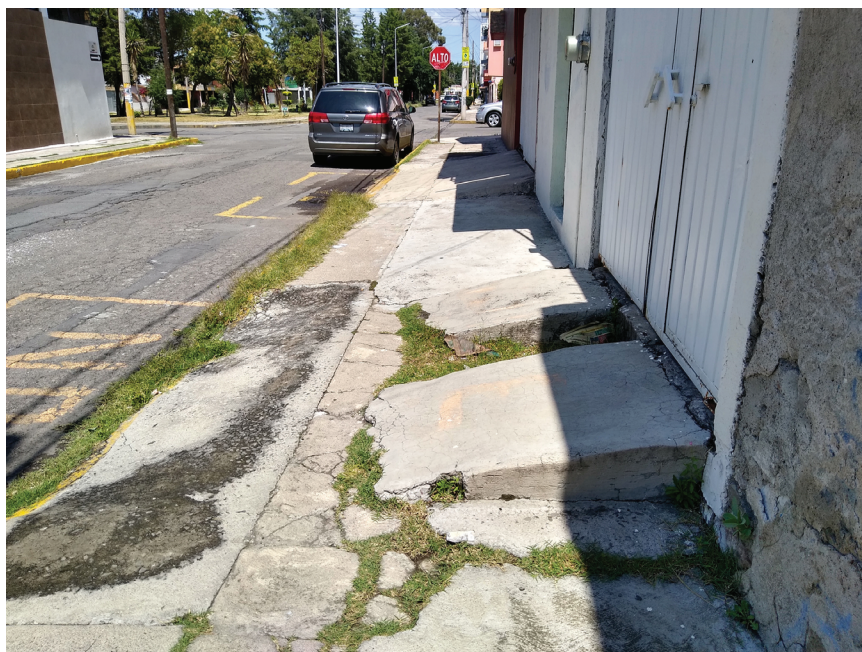
Figura 2. Malas condiciones de accesibilidad
